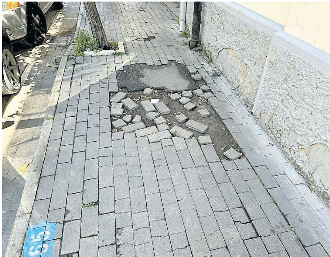
Mattonelle divelte, buche, avvallamenti, "trappole": è scontro sulla manutenzione
